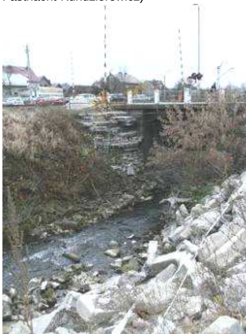
Fot. 9 Uszkodzone brzegi rzeki koło mostu na Gróbce w Rzezawie (Fot. K. Fastnacht-Kundzierewicz)
