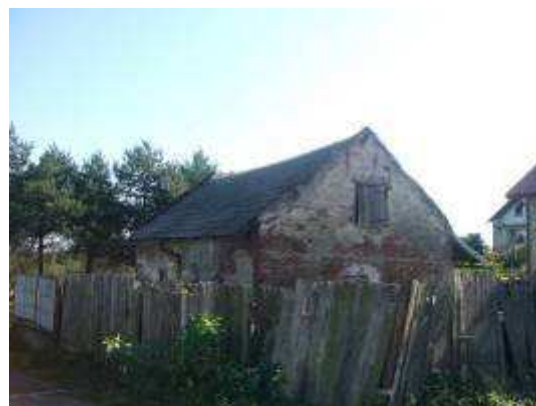
Fot. 32. Zaniedbany budynek mieszkalny o cechach zabytkowych w sołectwie Rzezawa (Fot. B. Szwed)
