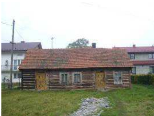
Fot. 31. Niszczący dom o cechach zabytkowych w sołectwie Jodłówka (Fot. B. Szwed)
