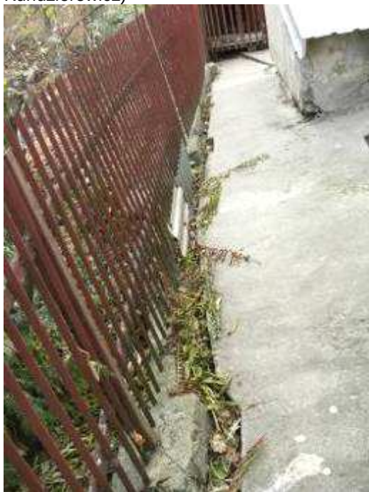
Fot. 8 Uszkodzone ogrodzenie po powodzi w 2010 r. Powstało zagrożenie dla budynku mieszkalnego (Fot. K. Fastnacht-Kundzierewicz)
